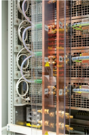
直流总线端 / DC bus terminal
